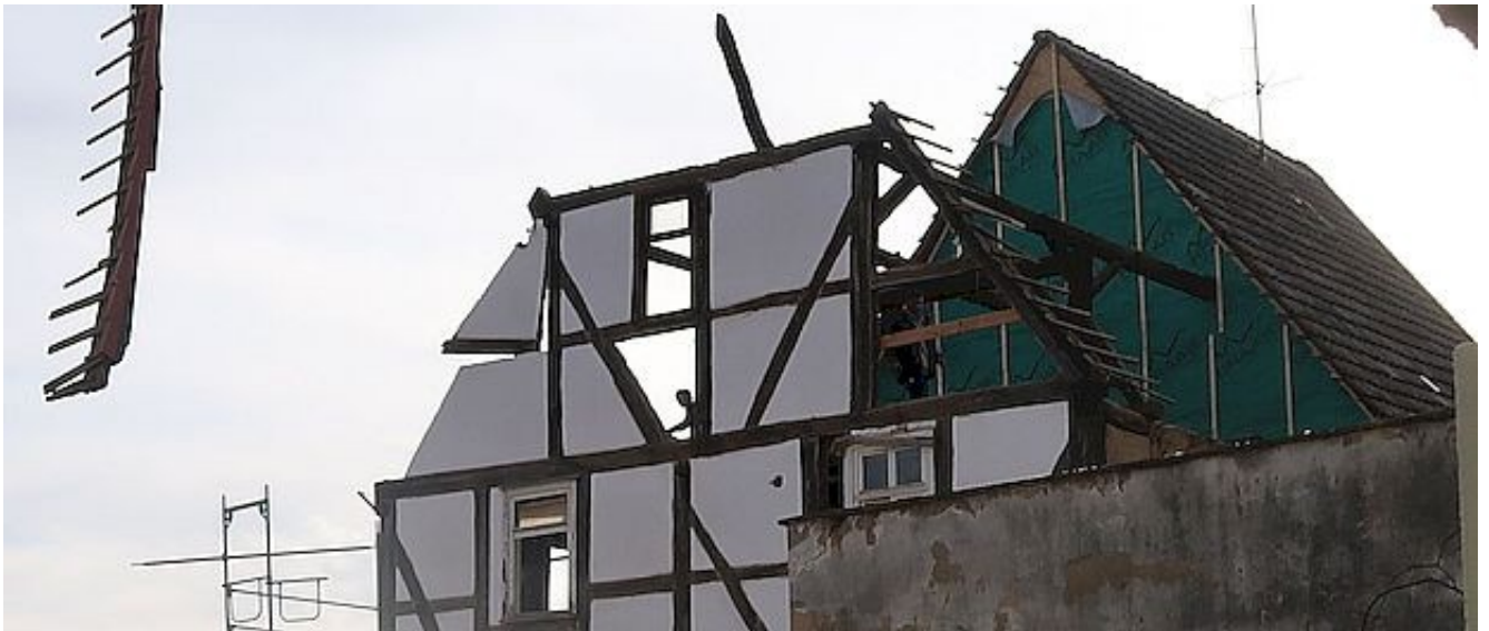
Foto: Abriss des Kulturdenkmals, Arbeiter ohne Schutz
